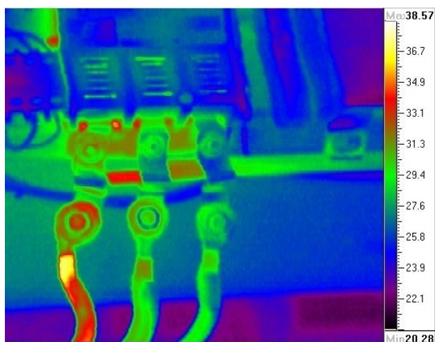
Рисунок 21. Пример термограммы контактных соединений с температурной шкалой
